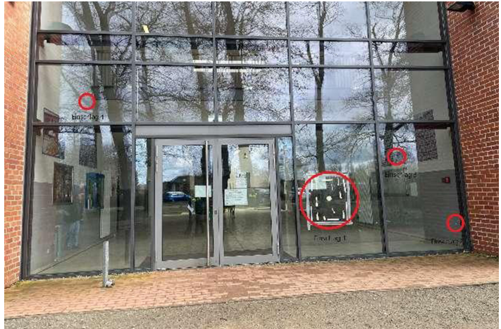
In den rot markieren Bereichen wurden die Scheiben beschädigt / Foto: Polizei
